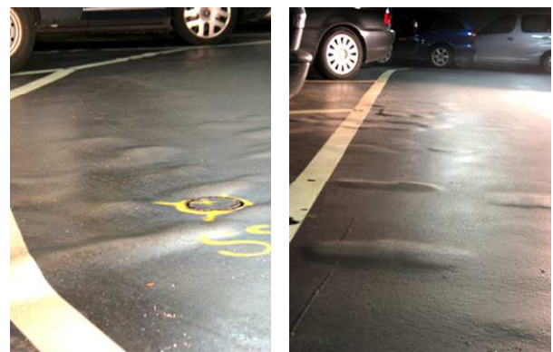
Abbildung 5: Großflächige Blasenbildung in der Gussasphalt-Beschichtung
