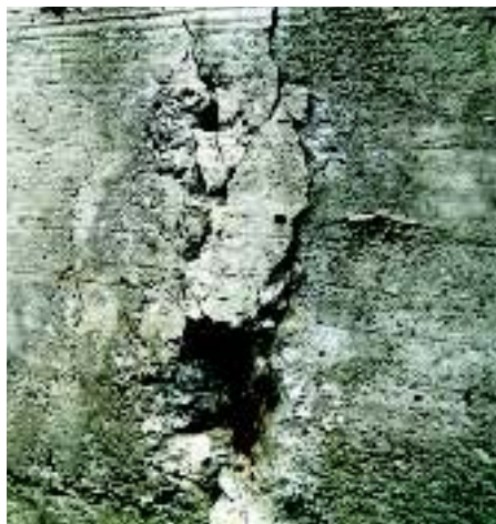
Bewehrungskorrosion infolge Karbonatisierung des Betons.
